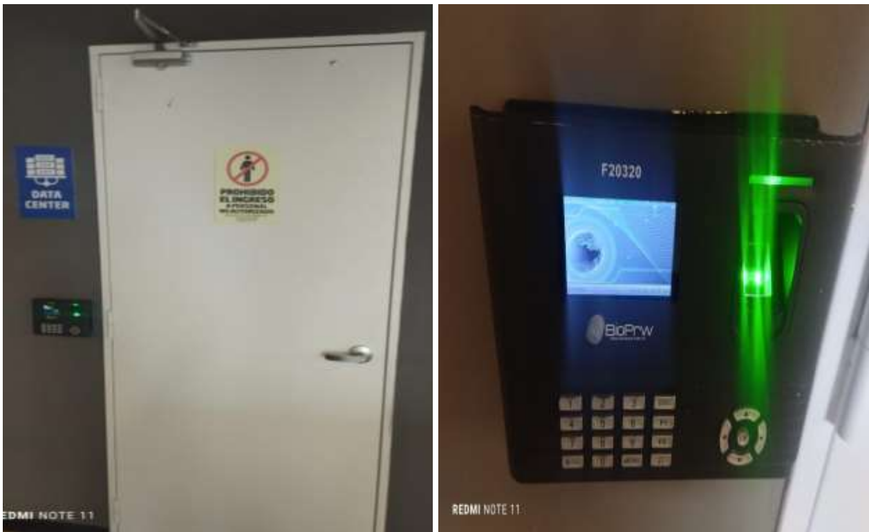
Ingreso al Datacenter
