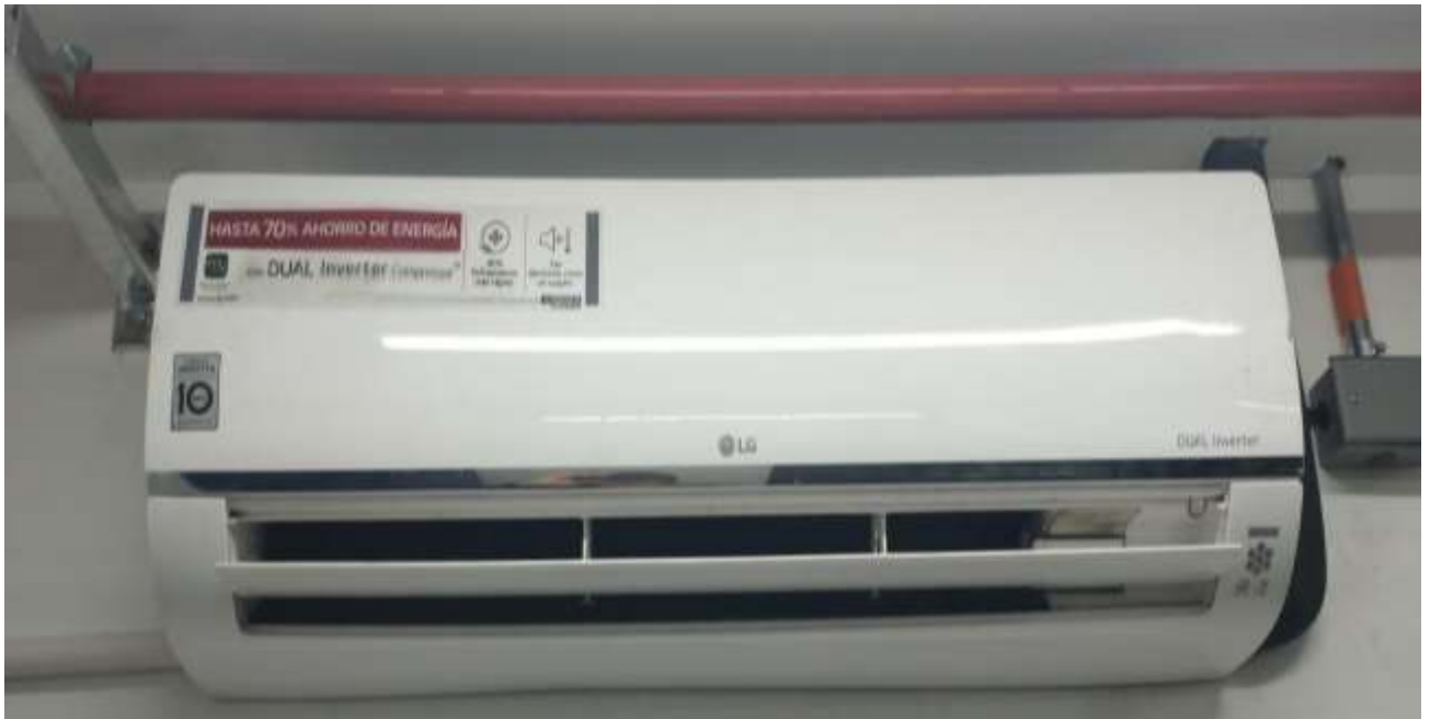
Sistema de refrigeración alterno por Mini Split 2
