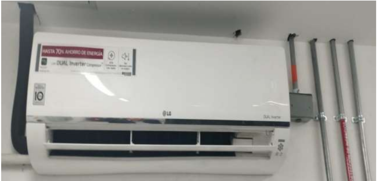
Sistema de refrigeración alterno por Mini Split 1
