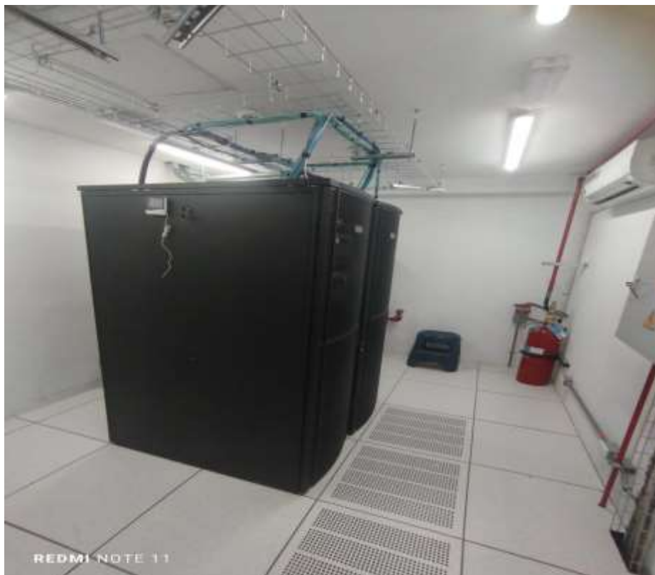
Organización y espacios del Data Center
